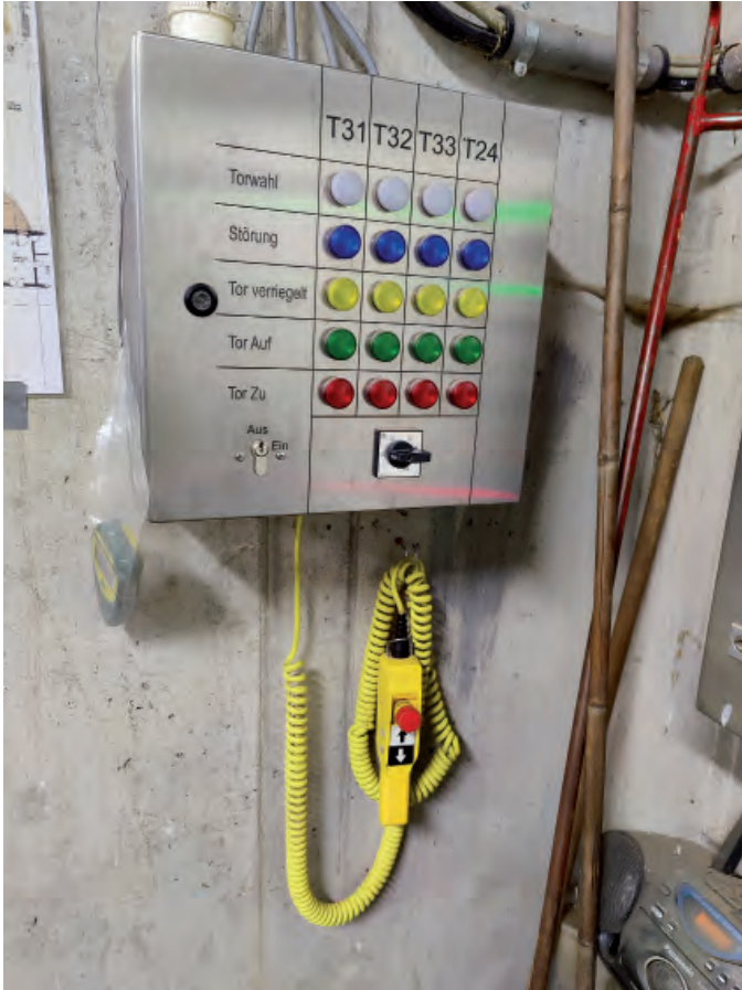
Abb. 13: Kontrollpult mit verbundenem Handschalter zur Bedienung der automatischen Tore. Nur die jeweils vom Standort einsehbaren Tore können von hier aus bedient werden. Foto: Zoo Dresden
