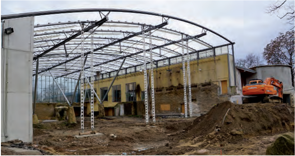
Abb. 5: Blick ins entkernte Afrikahaus mit fehlender Westfassade im Jahr 2016. Noch zu erkennen sind die v-förmigen Dachträger, welche später durch eine freitragende Dachkonstruktion ersetzt wurden. Foto: Archiv Zoo Dresden
